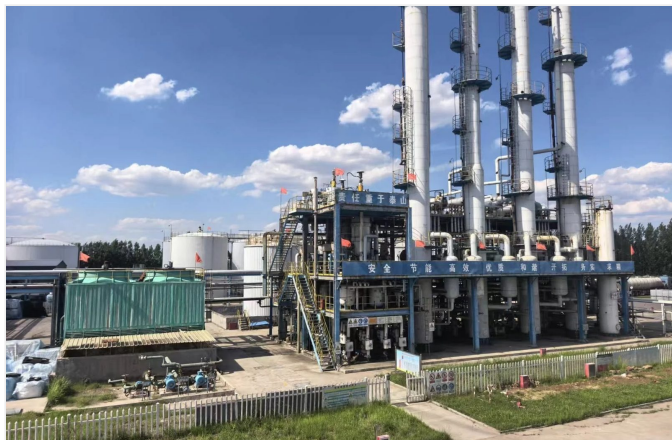
生产装置 & 储罐区 Production & Tanks
